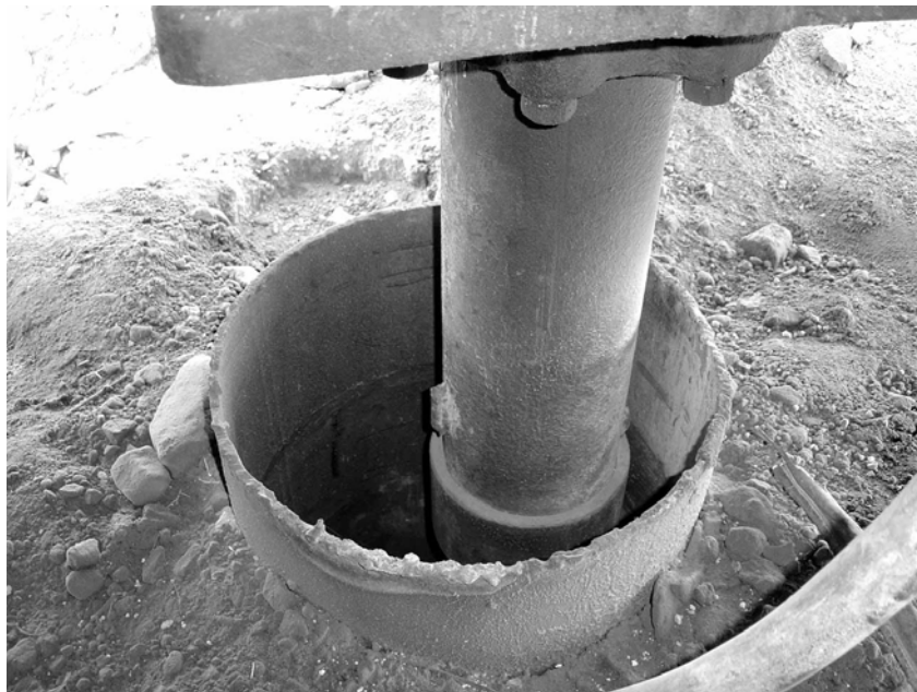
شکل ۱- بیرون آمدن منصوبات چاه آب (سبز شدن لوله) در منطقه حسین آباد رفسنجان
